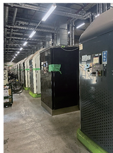
図1 Volter40発電施設の様子
