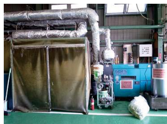
野菜室の横に設置されたボイラー
